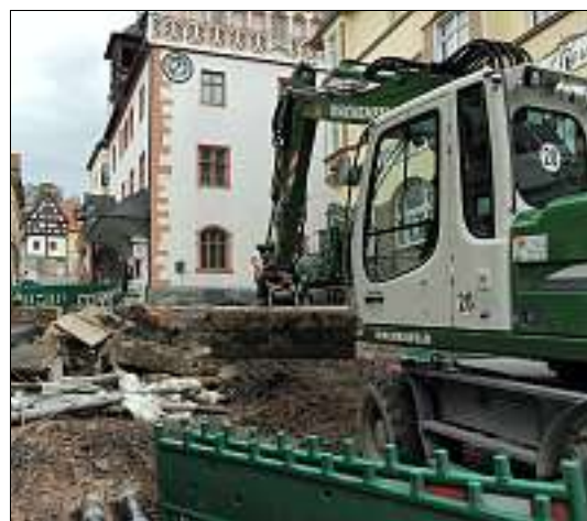
Im oberen Teil der Krautgasse sind die Tiefbauarbeiten in vollem Gange. Foto: Brit Wollschläger
